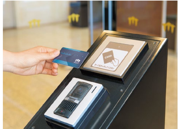
カードによるセキュリティ
