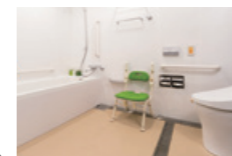
ユニバーサルルームのユニットバス
